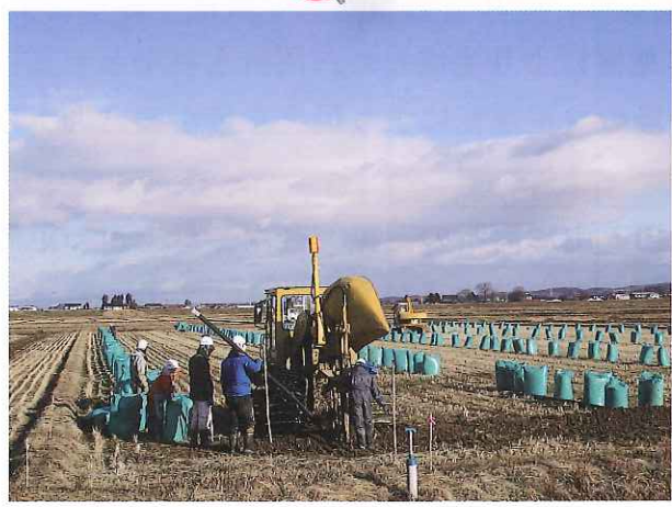
農地耕作条件改善事業 豊里(8)地区 暗渠排水工事実施状況
